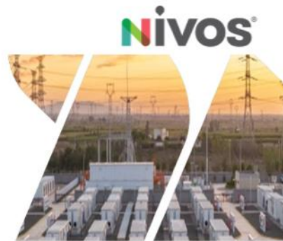
Nivos 10 MW / 20 MWh
